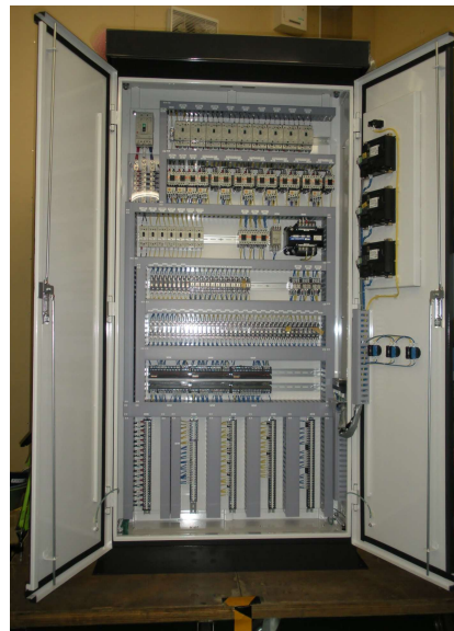
制御盤 盤内例③
