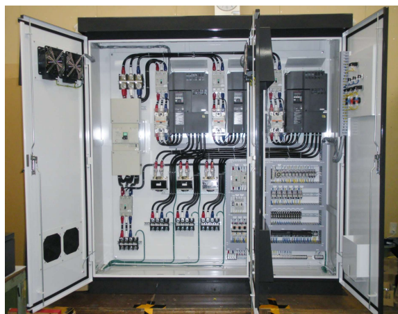
制御盤 盤内例①
