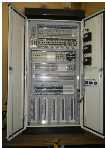
制御盤 盤内例③
