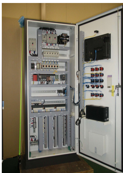
制御盤 盤内例②
