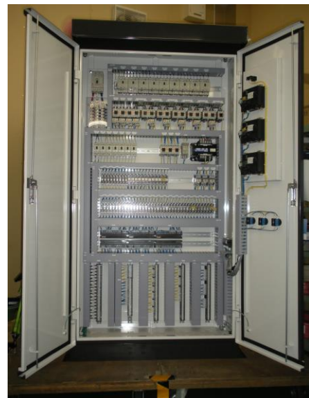
制御盤 盤内例③
