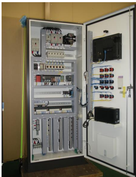
制御盤 盤内例②
