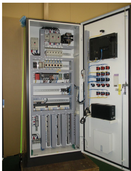
制御盤 盤内例②
