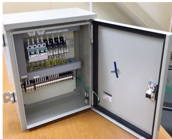
配電ボックス
