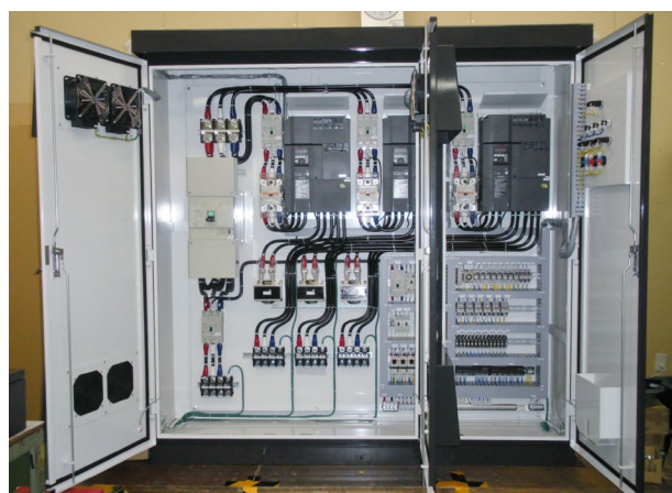
制御盤 盤内例①
