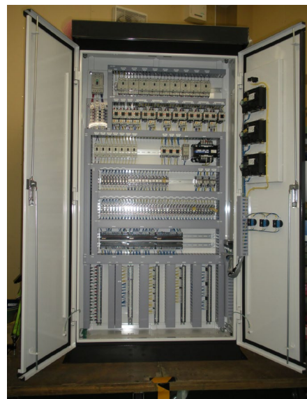
制御盤 盤内例③
